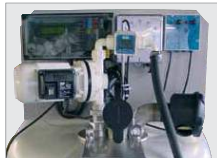
Outdoor-tankinstallatie zonder pompkast
