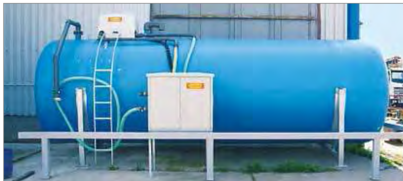
Compleet geïnstalleerde natzoutinstallatie incl. pompeenheid
